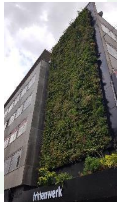
Abbildung 27: Wandgebundene Fassadenbegrünung in der Essener Innenstadt, © EGLV, Andreas Giga
