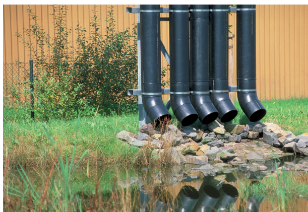
Hierhin ging das erste Wasserzeichen: Versickerungsmulden der Fa. Vogt electronic aus Witten
