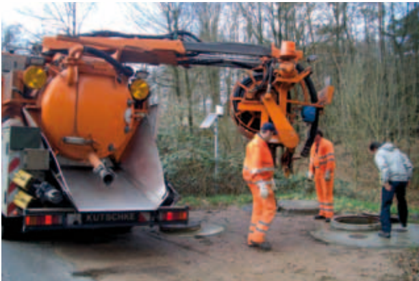
Abb. 3: Wartung einer dezentralen Anlage in Hamburg
