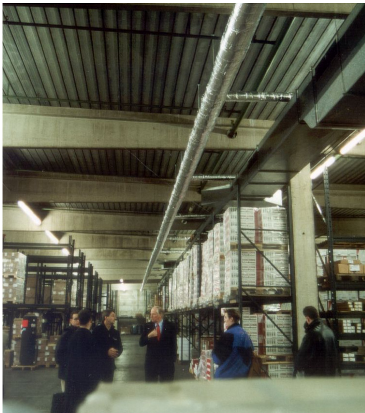
Abb. 1: Fa. Stiebel-Eltron, die Umlegung der Entwässerung unter der Hallendecke ist kostengünstig und erhält die notwendige lichte Höhe für den Staplerbetrieb
