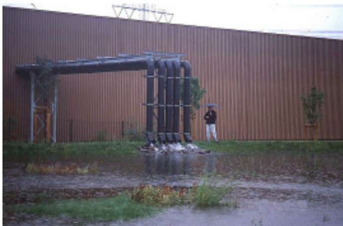
Abb. 14: Offene Ableitung der Dachabflüsse über Rohrbrücken
